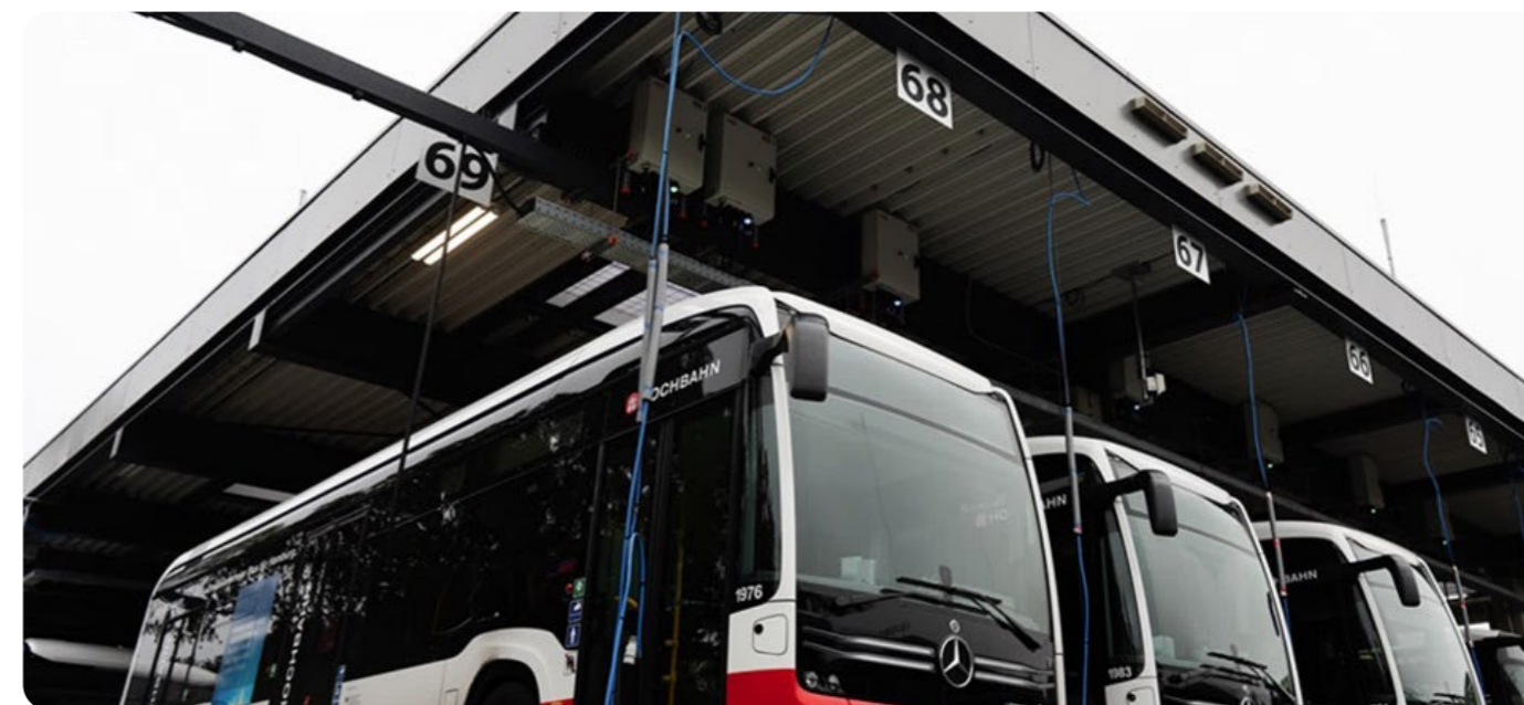
Umiestnenie CCS nabíjacej stanice pod prístreškom so zveseným nabíjajúcim káblom v depe mesta Hamburg (Zdroj: Hamburger Hochbahn)
